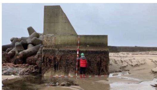
地盤隆起した漁港の状況
