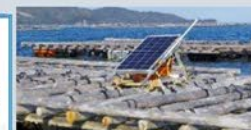
テレメーター設置例
