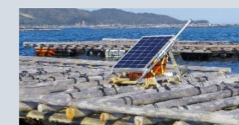
テレメーター設置例
