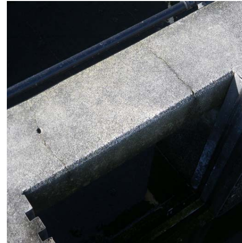
劣化した施設例（飼育池の亀裂）
