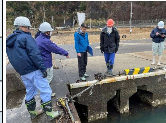
MAFF-SATによる被災状況調査
