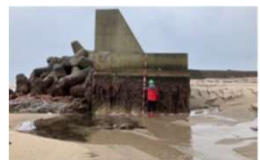
地盤隆起等の被災
