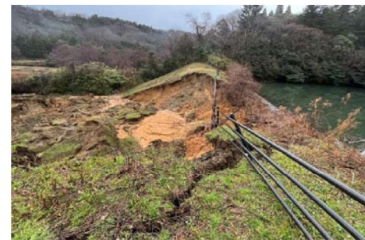
ため池の被害
