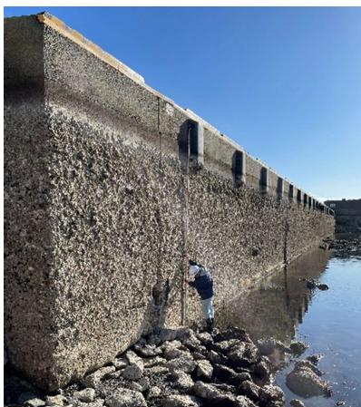
地盤隆起した鹿磯漁港
