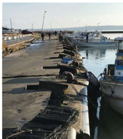
物揚場が傾倒した石崎漁港
