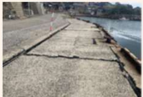
物揚場の段差（富来漁港）
