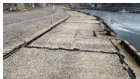
亀裂、段差等の被災
