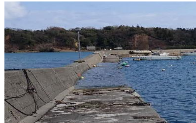
防波堤の沈下・傾斜
