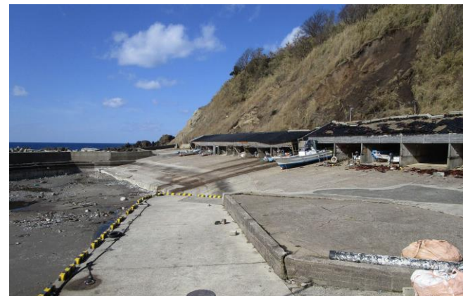
物揚場・船揚場の隆起・傾斜
