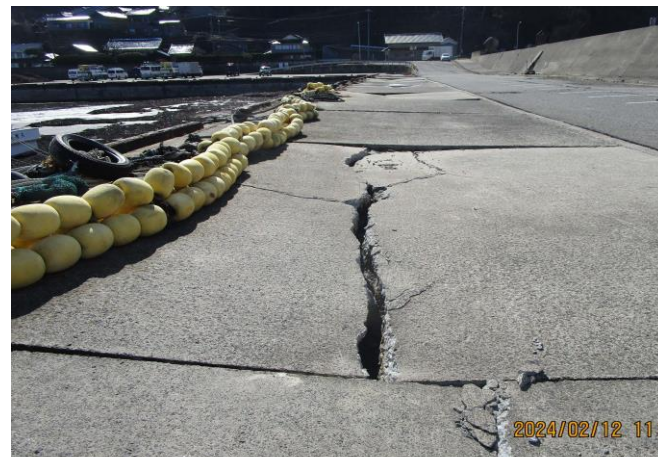
背後エプロンの亀裂・陥没
