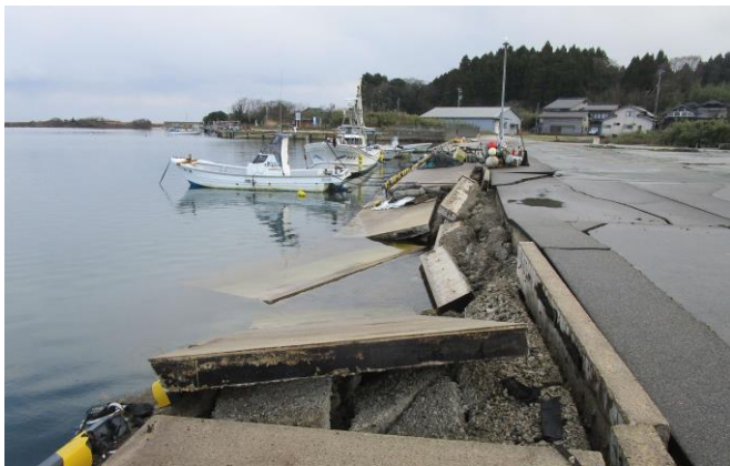
本体ブロック倒壊、背後エプロン崩壊
