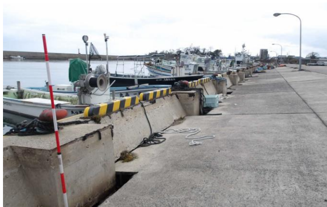
本体ブロック傾斜、背後エプロン沈下
