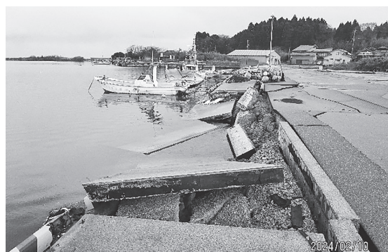
図-1 地震の揺れや沈下等による被災(野崎漁港)
