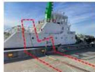
(船溜まりの陸上電力供給)
