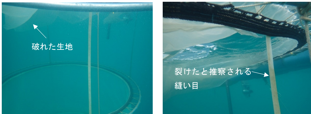
図-I.2.16 バンドル収容部の破損
