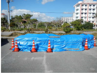
石垣港ふ頭用地で仮置確認
