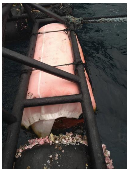
図 2-2-6 崩壊したフロートカバー
