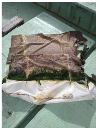
図 2-2-8 崩壊したフロートカバー
