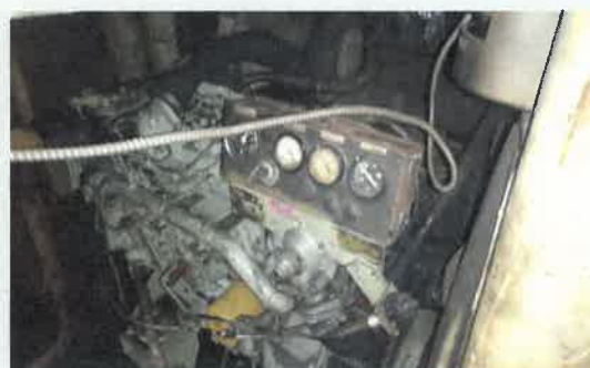
主機関 (機側側制御)
