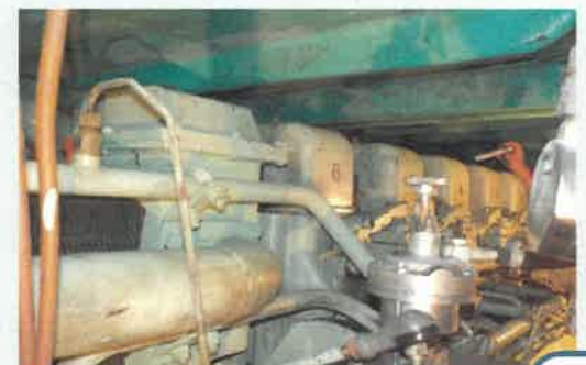
機関室内の様子
